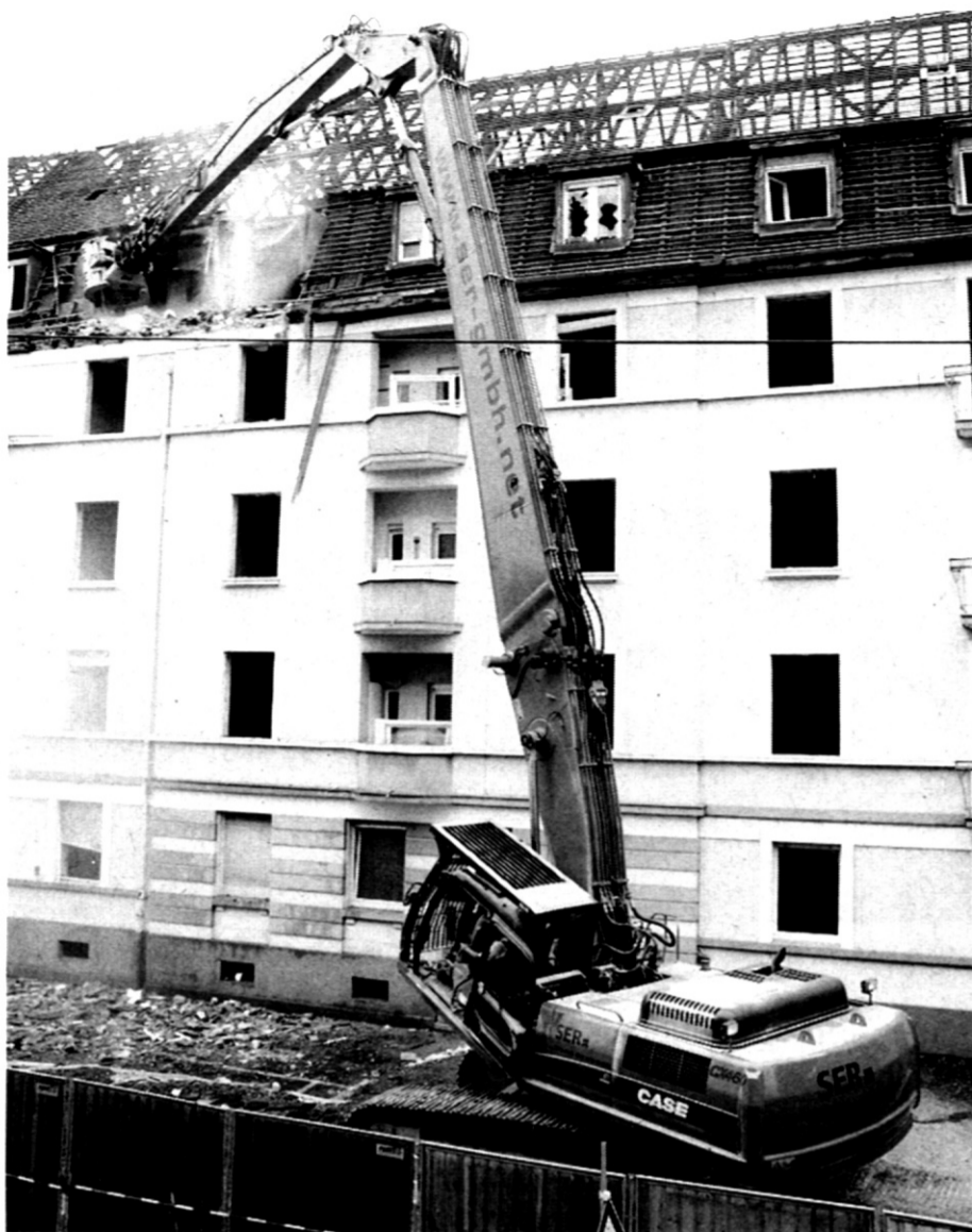
Die Firma SER aus Bad Rappenau setzt einen Case Raupenbagger vom Typ CX 460 mit Abbruchausrüstung ein. Das insgesamt rund 60 t schwere Gerät ist mit einer dreiteiligen Arbeitsausrüstung und einem zusätzlichen Gegengewicht von 4,5 t ausgestattet und erlaubt Arbeiten bis zu einer maximalen Höhe von 26 m bei einer Reichweite von 14 m. Als Werkzeug kommt ein Steck-Abbruch-Greifer mit hydraulischer Drehvorrichtung und Schnellwechsler zum Einsatz. Foto: Case
